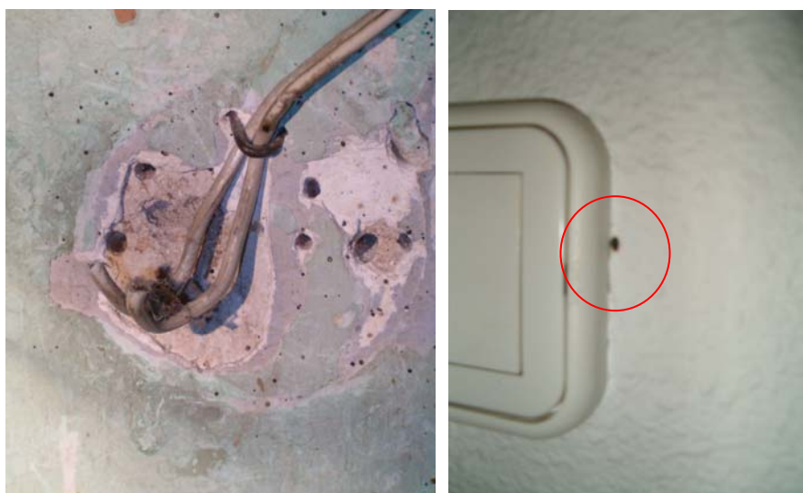
Chinchas; Pasa-tubo eléctrico en dormitorio infestado; estos pasatubos sirven con frecuencia como vía de diseminación del parásito de una habitación/vivienda a la próxima, especialmente en situaciones de aplicación insecticida incorrecta (aerosoles/termonebulizaciones). (Fotografías UTCV-Madrid Salud)
