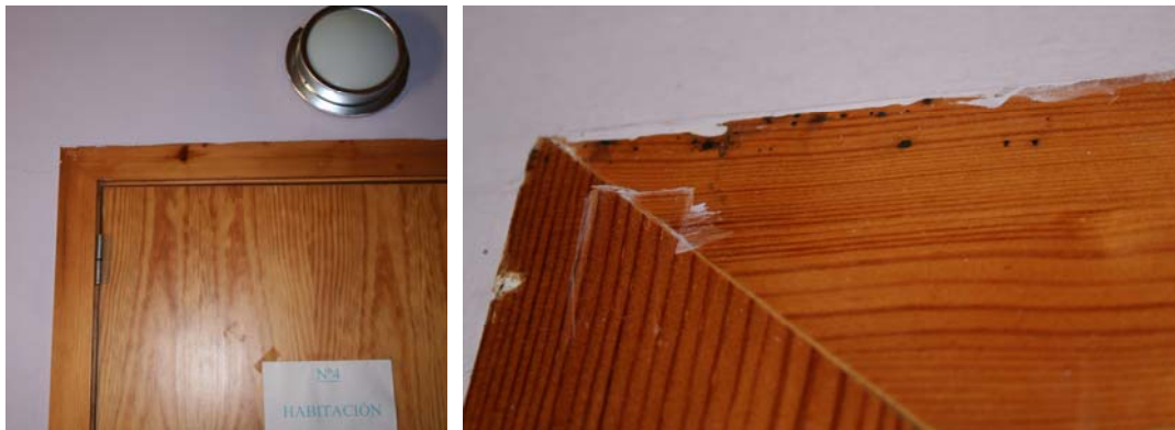
Manchas fecales en carpintería (madera) de dormitorio colectivo (albergue) (Fotografías UTCV-Madrid Salud)
