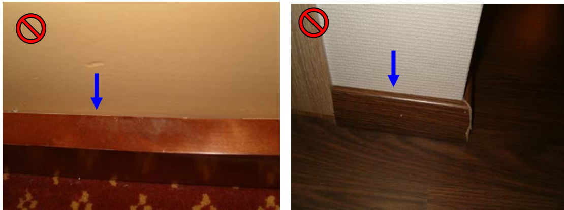
Rodapiés; la presencia de moqueta (izquierda) supone un riesgo especial y complica la efectividad de los tratamientos. (Fotografías UTCV-Madrid Salud)
