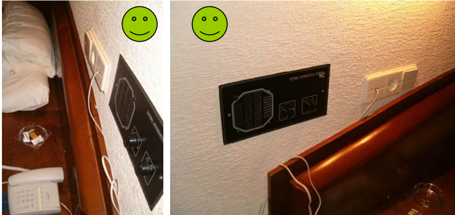
Interruptores eléctricos no integrados en el mueble cabecero. (Fotografías UTCV- Madrid Salud)
