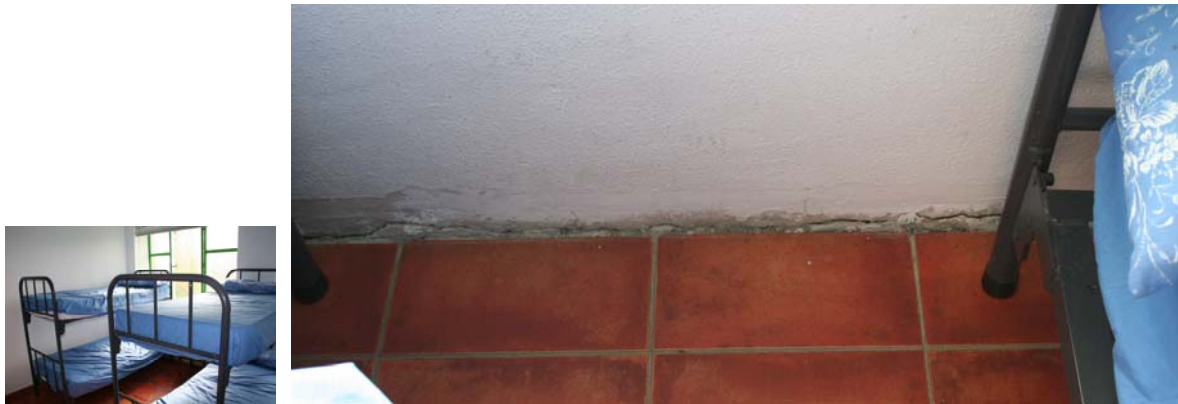
Infestación en suelo y espacio bajo rodapié. Albergue colectivo. (Fotografías UTCV-Madrid Salud)
