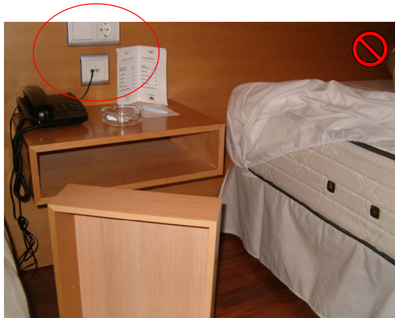
Interruptores eléctricos integrados en el mueble cabecero. (Fotografías UTCV- Madrid Salud)
