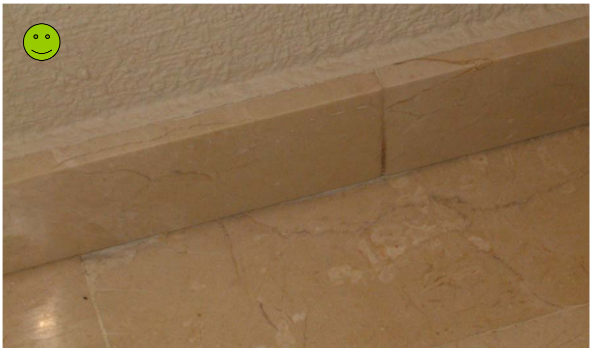
Rodapié cerámico; debe procurarse sellar adecuadamente (cemento blanco cola) todas las juntas entre las diferentes piezas del material y entre el rodapié y las paredes. (Fotografía UTCV-Madrid Salud)
