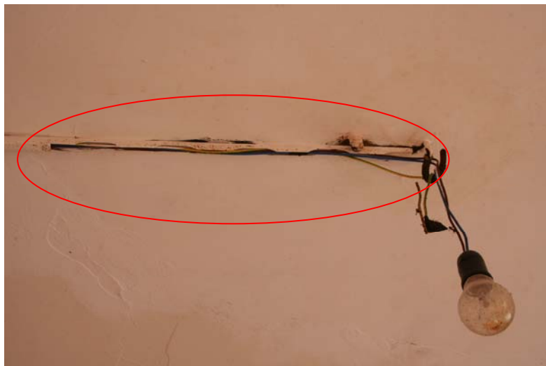
Infestación en techos y elementos asociados (luminaria, cableado, etc.). Albergue colectivo. (Fotografías UTCV-Madrid Salud)
