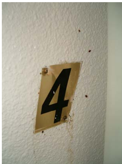
Chinches y spots fecales visualizados bajo elementos fijados en pared, los insectos han sido exteriorizados debido al tratamiento biocida insecticida realizado. (Fotografía UTCV-Madrid Salud)
