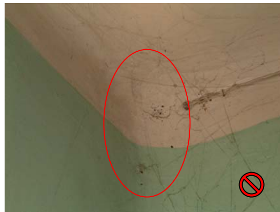
Techos; suciedad e insectos. (Fotografía UTCV-Madrid Salud)
