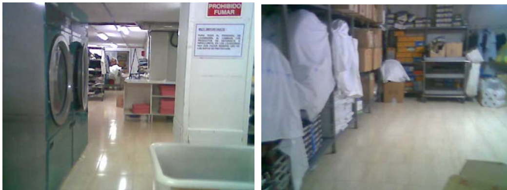
Local técnico (lavandería) de instalación colectiva. (Fotografía ANECPLA)
